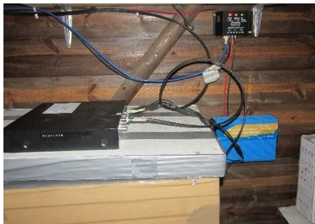
Слика 9.3. Контролни уређај напона струје за камеру Figure 9.3. Camera power supply control device
